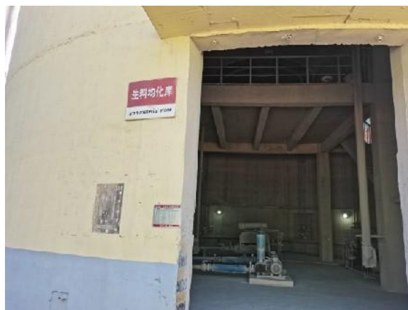
图 4-2 整改前（生料均化库）
